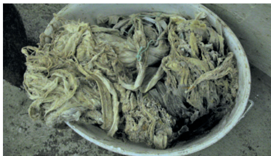
Diese Textilverzopfungen (Windeln, Handtücher etc.) steckten in einer Abwasserpumpe.
