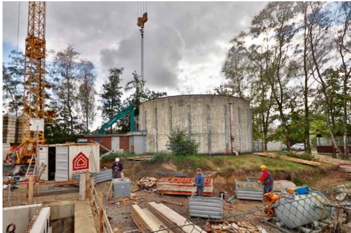
Ende des Jahres soll die neue Pumpenstation in Bad Waldliesborn fertig sein. Investiert werden 1,2 Millionen Euro.
